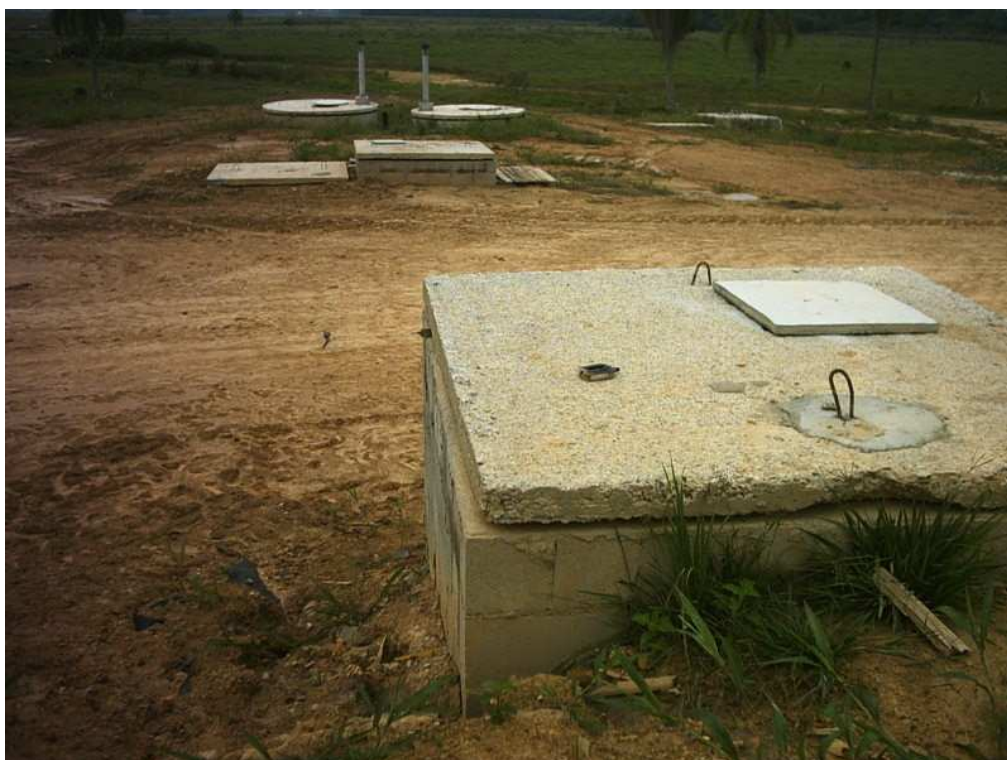
FIGURA 17 - Tanque de recepção, inspeção e armazenamento dos líquidos percolados respectivamente em 1º, 2º e 3º plano (Fonte:MANGILI, 2006).
